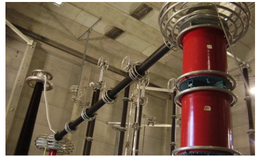
Resim 2: Yüksek Gerilim Test Lab.
