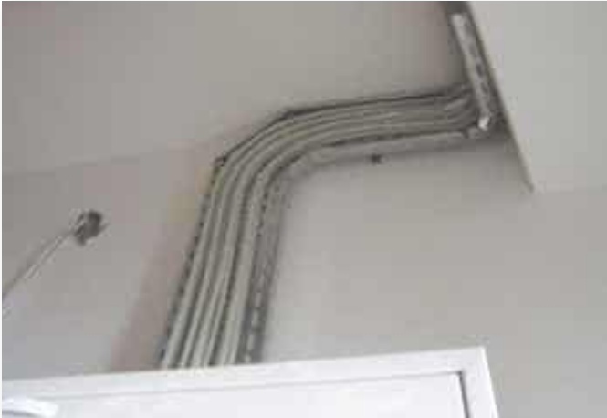
Kablolar bina içerisinde tek bir kanala döşenirler.
