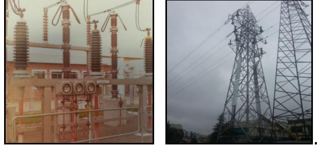
Resim 7 ve 8: Dış ortamda kullanılan kablo sonlandırma örneği ve havai hat örneği.
