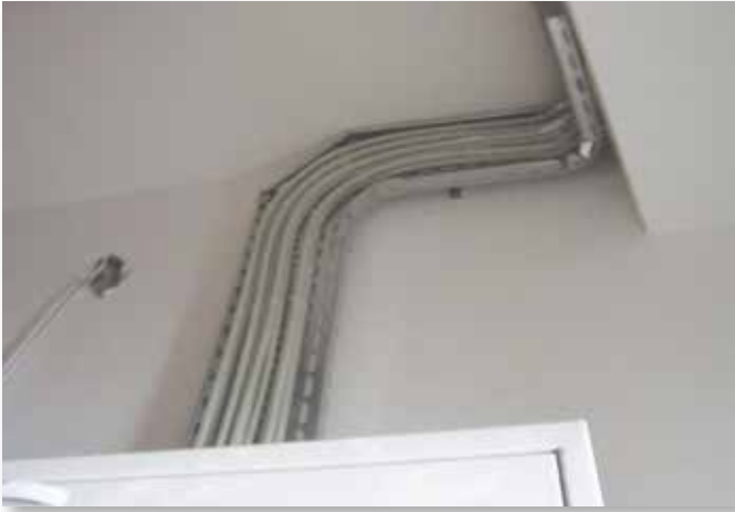
Kablolar bina içerisinde tek bir kanala döşenirler.
