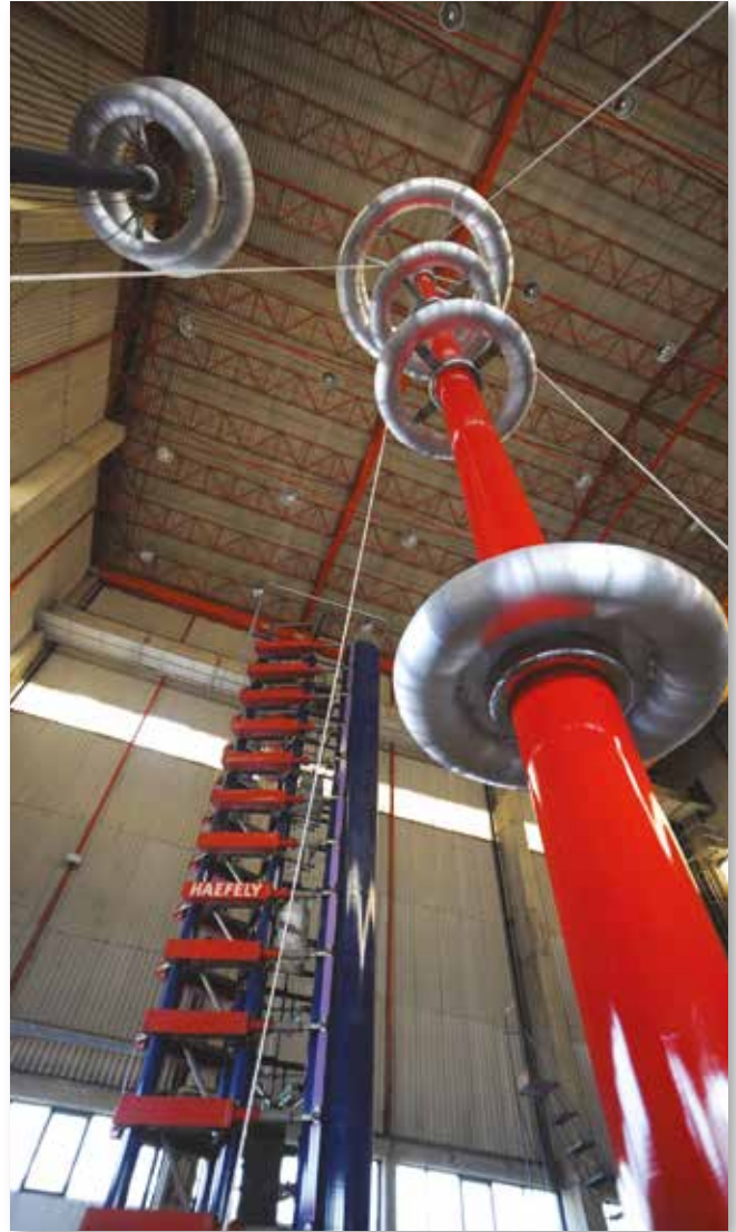
Yıldırım darbe jeneratörü gerilim bölücü.
