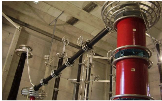
Resim 2: Yüksek Gerilim Test Lab.
