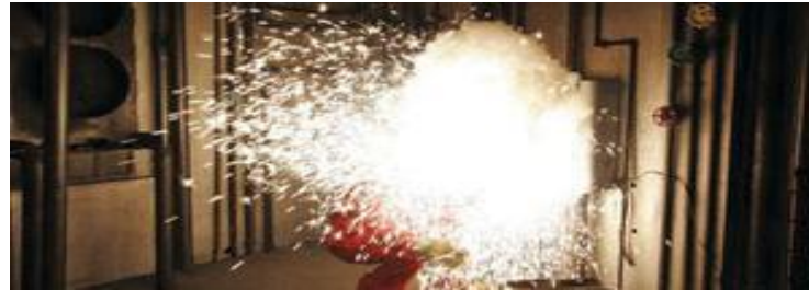
Resim 6: Kısmi deşarj sonrası oluşan kısa devre problemi ve gerçekleşen patlama
